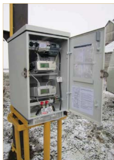
Новая катодная станция, установленная в с. Воронцовка Знаменского района
